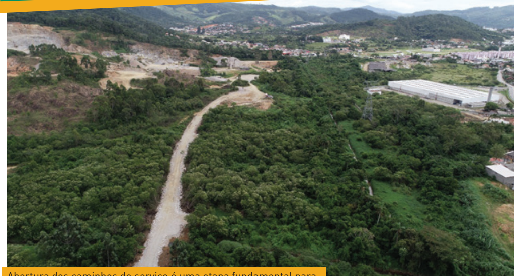
Abertura dos caminhos de serviço é uma etapa fundamental para garantir acesso do maquinário aos locais dos túneis e das obras
